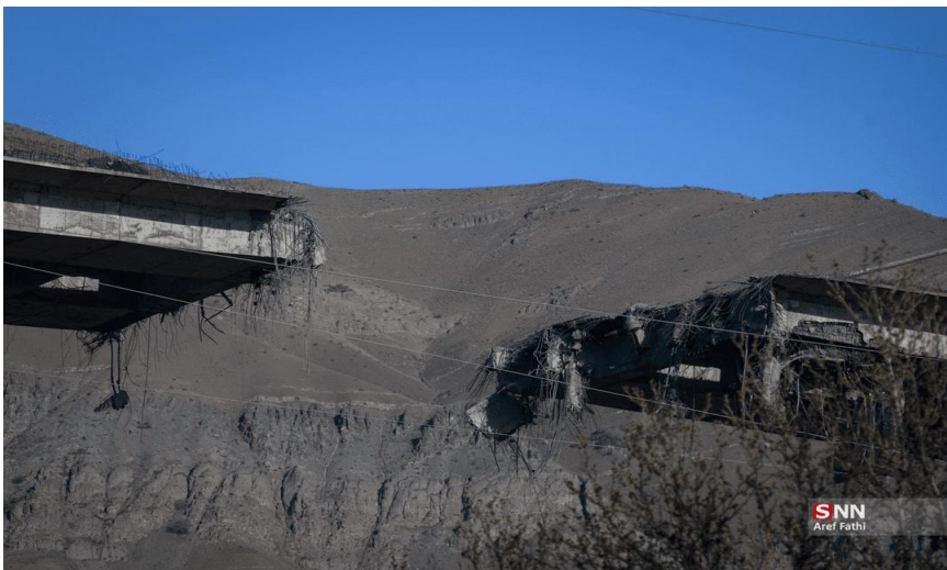
شکل ۱۲ تخریب پل B1 در کرج (خبرگزاری دانشجو، ۱۴۰۵)
