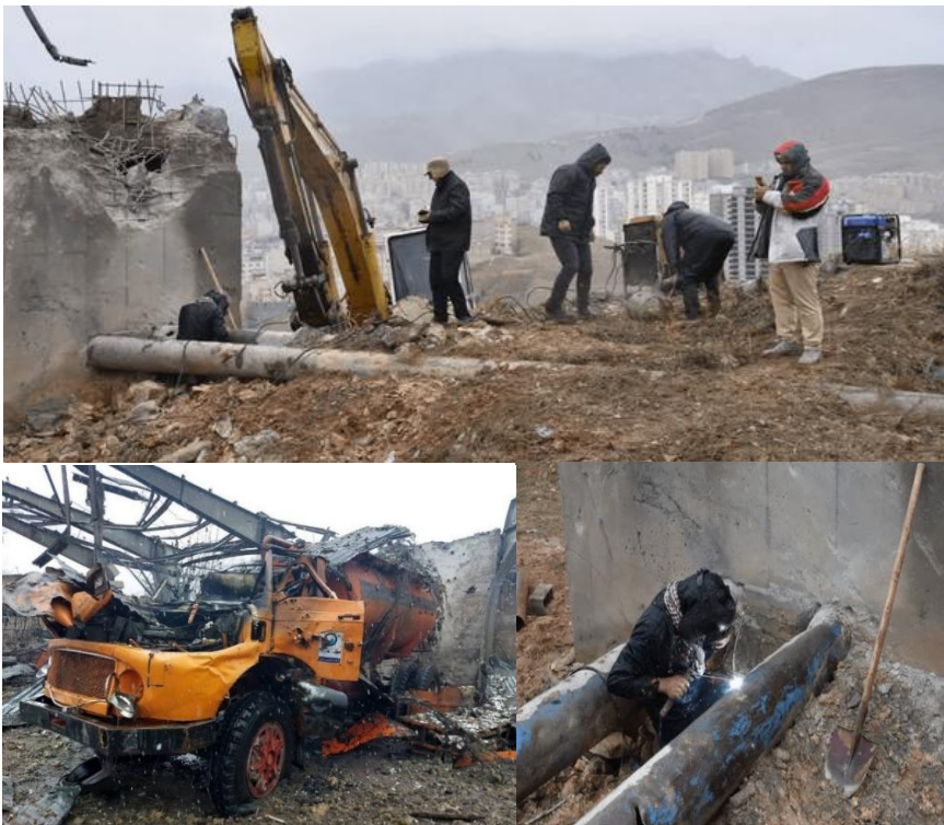
شکل ۳۲ تخریب خطوط انتقال آب (خبرگزاری فارس، ۱۴۰۵)
