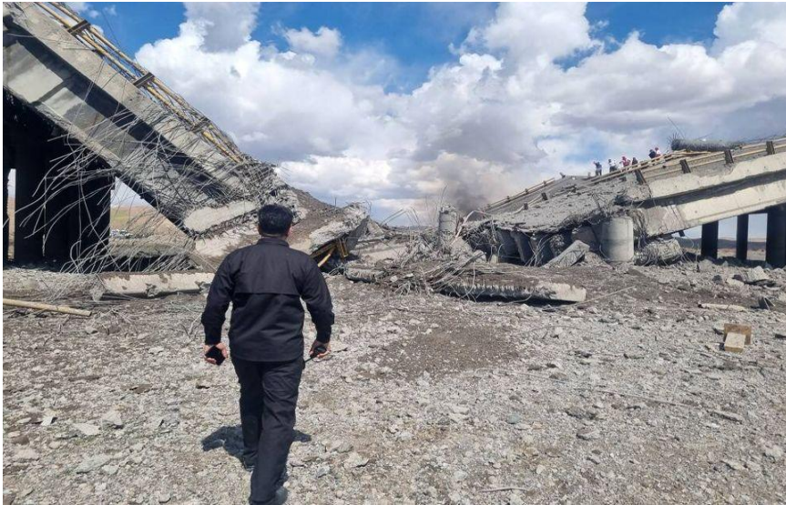
شکل ۱۱ تخریب پل هشتروند در آزادراه تبریز - زنجان (خبر فوری، ۱۴۰۵)
