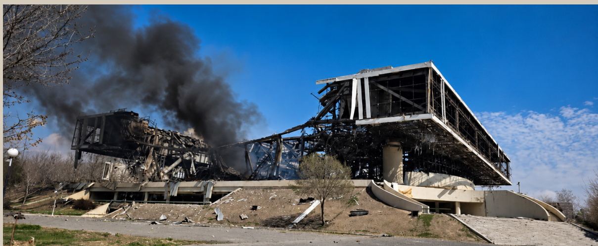
شکل ۲۷. تخریب ورزشگاه ۱۲,۰۰۰ نفری آزادی در تهران
