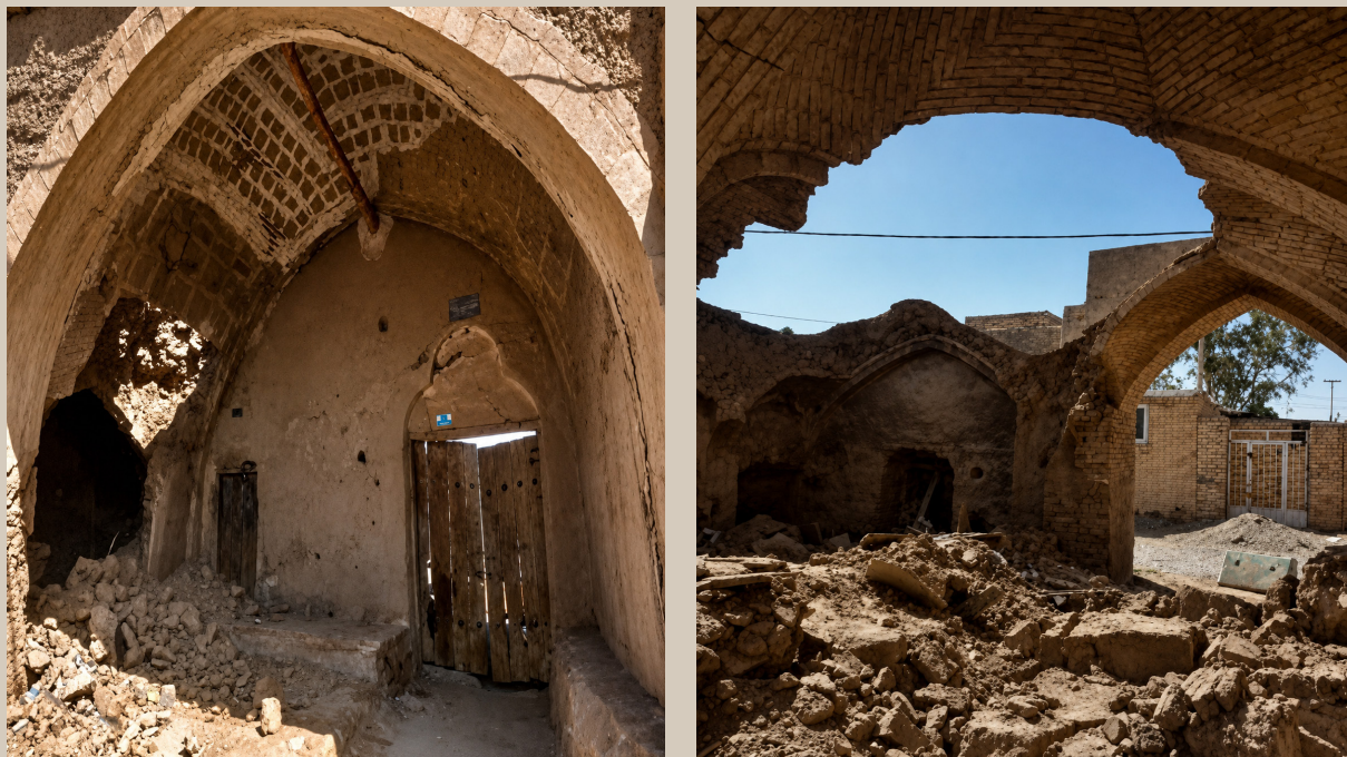
شکل ۳۳. آسیب شدید به باروهای ساسانی در منطقه کوهپایه اصفهان
