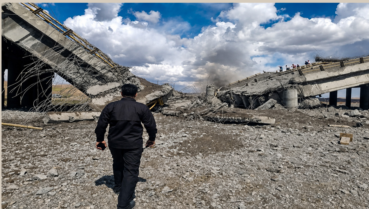
شکل ۱۱. تخریب پل هشت‌رود در آزادراه تبریز-زنجان
