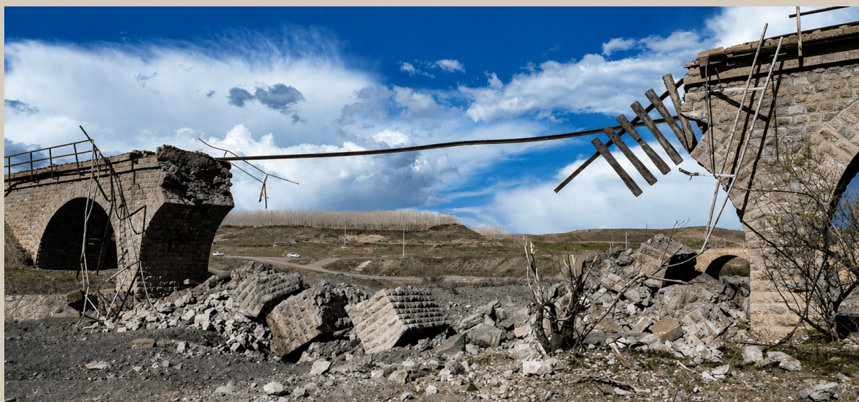
شکل ۱۶. تخریب پل راه‌آهن قم
