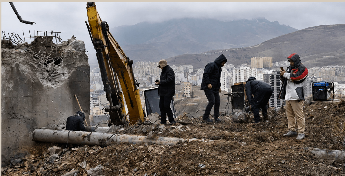
شکل ۱۹. آسیب به خطوط انتقال آب
