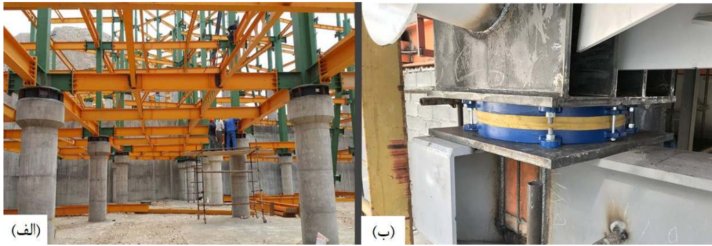
تصویر شماره‌ای ۲- استفاده از جداگرهای لرزه ای در (الف) بیمارستان امام حسین (ع) کرمانشاه و (ب) پل ارتباطی مجتمع تجاری پالادیوم تهران
